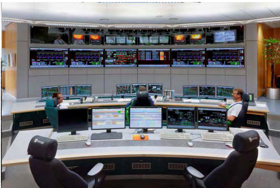
RMVA Köln, Leitwarte, Quelle: AVG Köln
