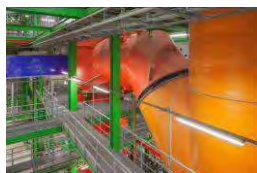
RMVA Köln, Sortieranlage, Restmüllbunker, Turbinenhalle und Abgasreinigung, Quelle: AVG Köln
