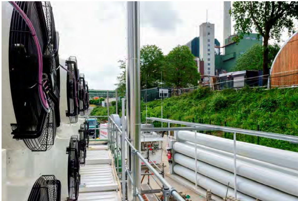
AWG Wuppertal, Wasserstoff-Produktion, Quelle: AWG Wuppertal
